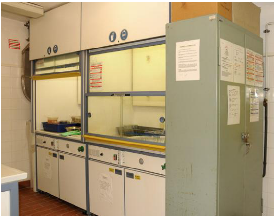
Bild 14: Bild eines Digestoriums.
